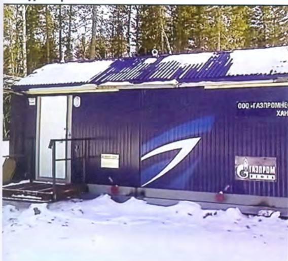
Рис. 5. БНС 1700-350 на базе насосной установки с ПЗД на промысле
