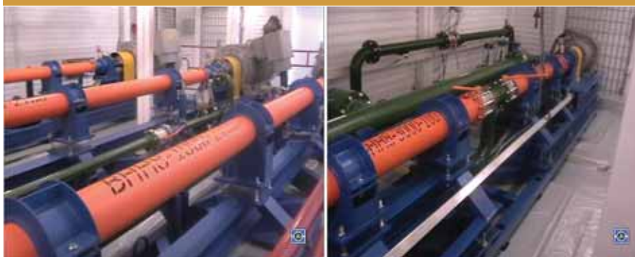
станция укомплектована установкой повышения давления для забора жидкости из резервуара
